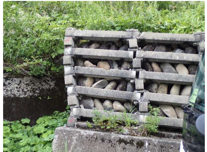
図 24 地すべりによる構造物のゆがみ
